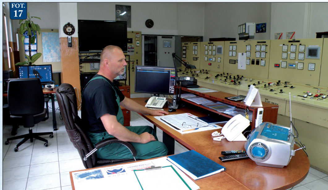
Fot. 17 – Nastawnia Elektrowni Żur, a w niej operator (dyżurny) Aleksander Willim, znany w środowisku z działalności społecznej; od 12 lat prezes Koła Nr 113 w Osie Polskiego Związku Wędkarskiego, które zarybia (m.in. szczupakiem) Zalew Żurski. Gospodarkę rybacką prowadzi na tym akwenu wodnym Zarząd Okręgu PZW w Bydgoszczy
