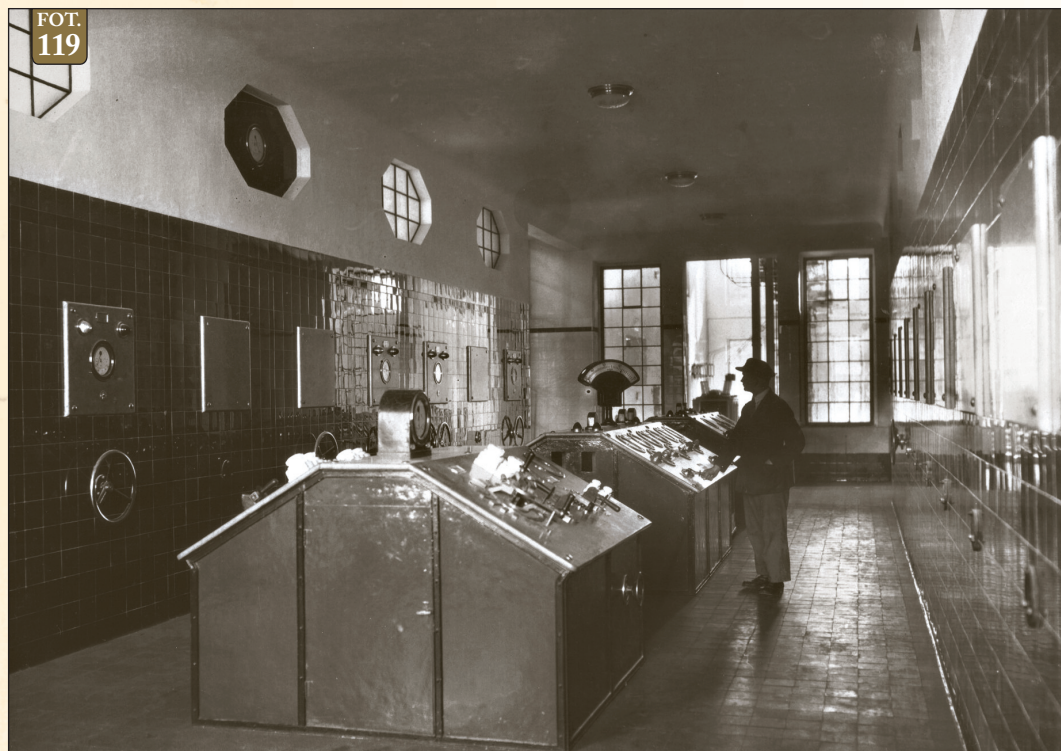
Fot. 119 – Nastawnia Podstacji 60 kV/15 kV PEK „Gródek” w Gdyni, w sierpniu 1928 r.
